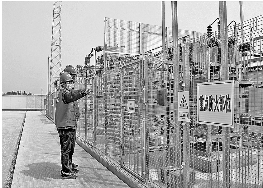
图为110千伏固拉合玛变电站。
