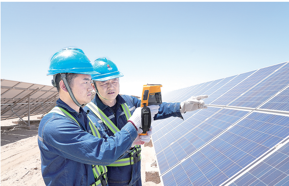
7月14日,中电投和田光伏电站工作人员进行巡检作业。 地区融媒记者 阿卜力克木摄
