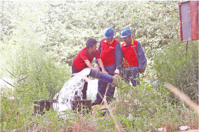
国网墨玉县供电公司工作人员检查桃园采摘基地用电设备运行情况。地区融媒通讯员 乃比江摄
