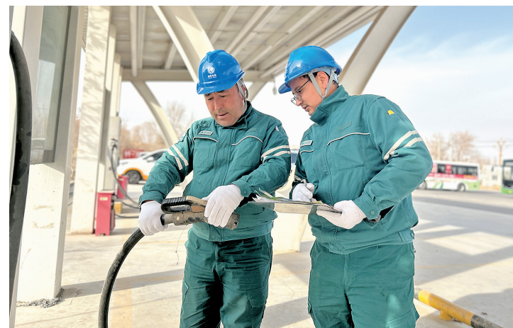
国网洛浦县供电公司组织工作人员对重点区域的公共充电桩开展全方位专项检查。地区融媒通讯员 伊丽米努尔摄
