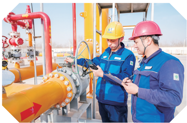
2月17日,和田家和天然气有限公司工作人员在燃气场站对关键设备进行检测。地区融媒记者 伊尔番摄
