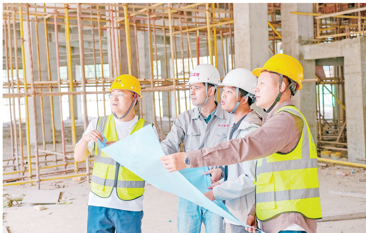
4月14日,和田夜市项目施工现场,技术人员与监理人员对照图纸,研讨施工细节。
