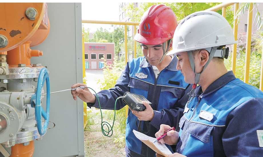
工作人员开展户外燃气管网及设备安全巡检工作。地区融媒记者 宋俞霖摄
