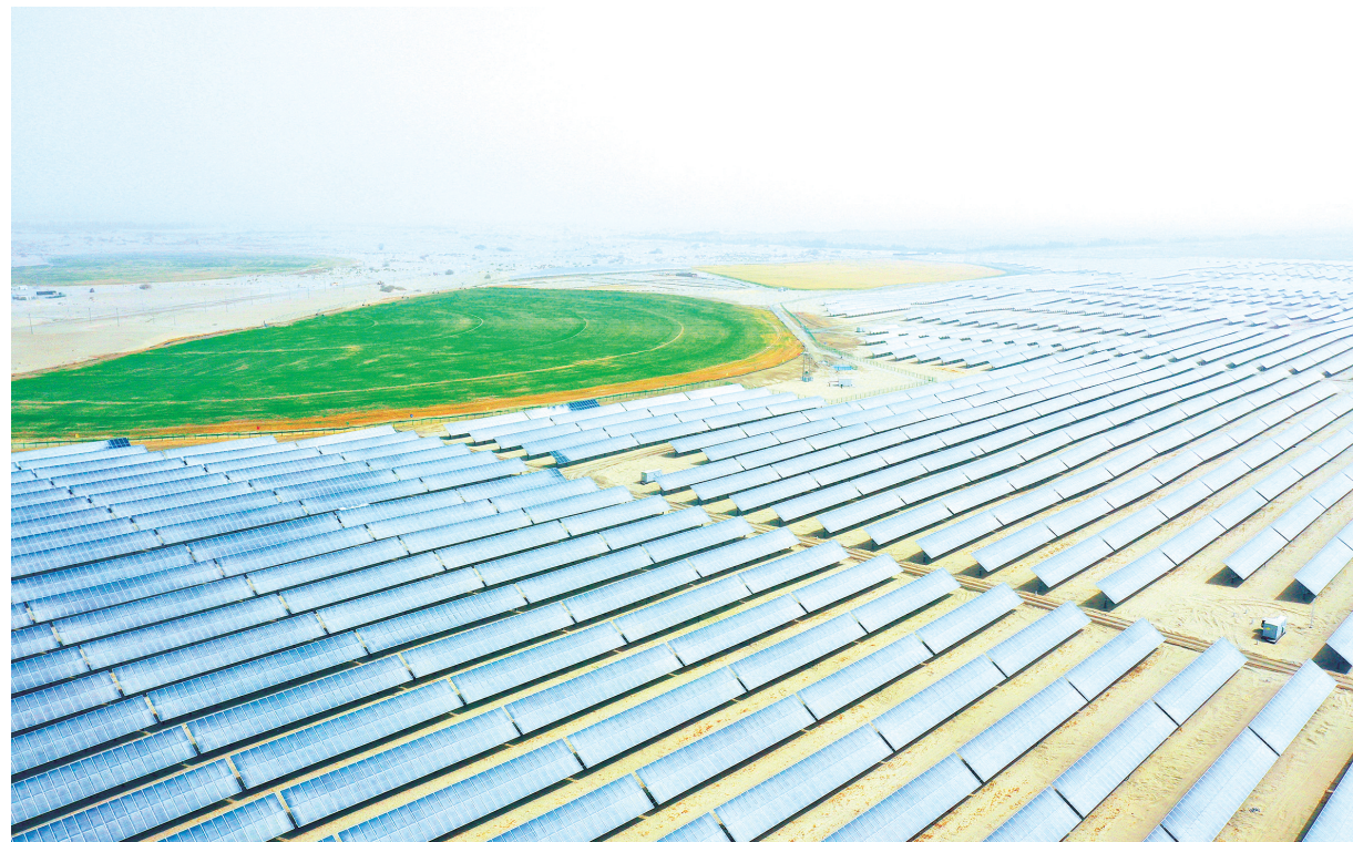
中广核新疆洛浦县五十万千瓦光伏治沙示范项目一角。
